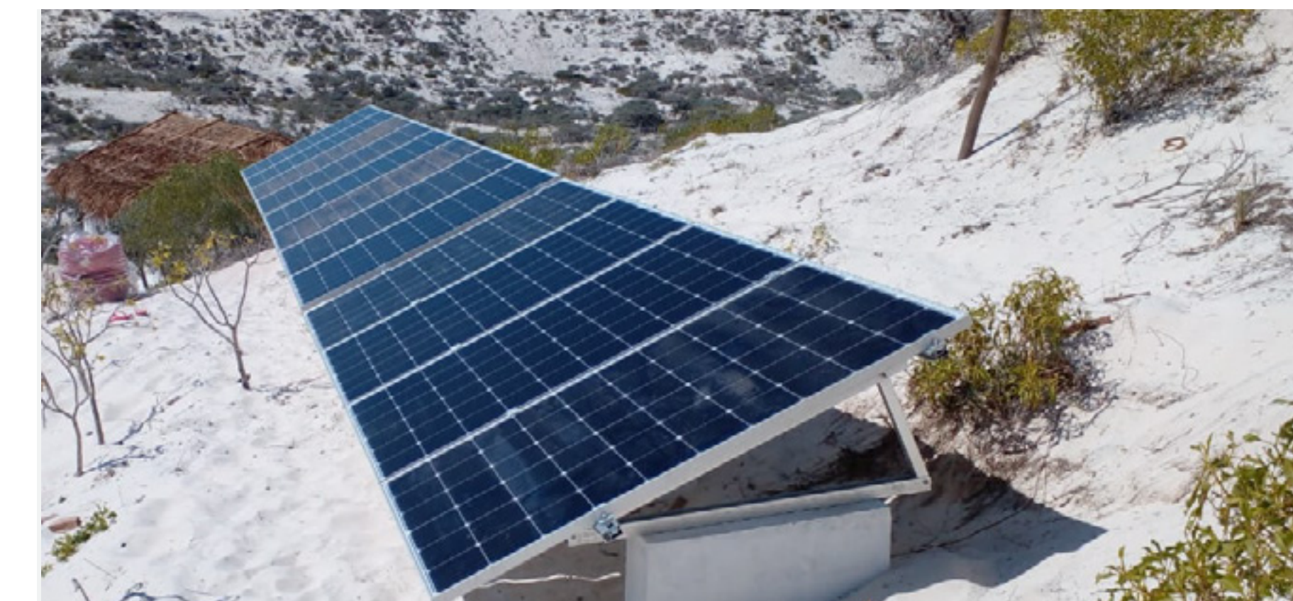
FONDATION AXIAN Fourniture et installation solaire à Tulear
