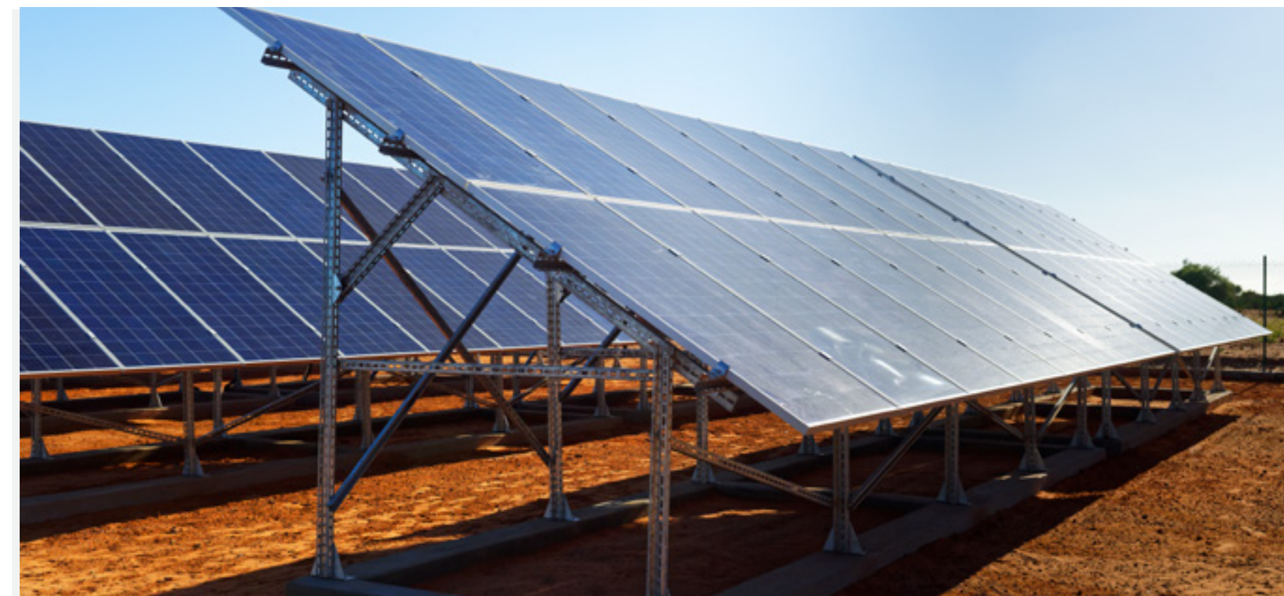
FONDATION AXIAN PhaGDis ANTANAMBAO : Fourniture et installation d'un Kit Solaire OFF-GRID 3 kVA 1 banc 190Ah
